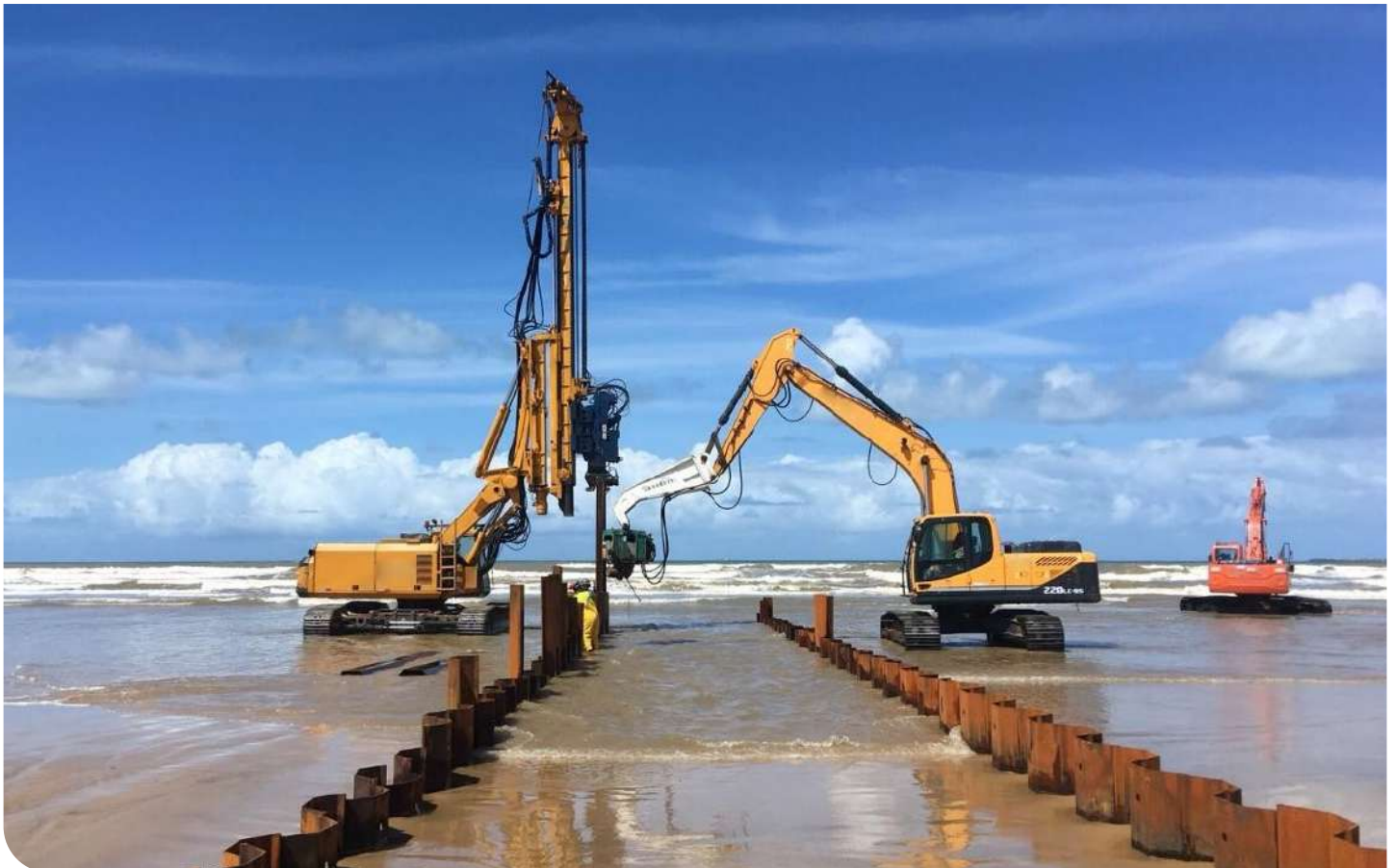
Martelo vibratório acoplado em equipamento com torre guia e em escavadeira Local: UTE Porto de Sergipe
