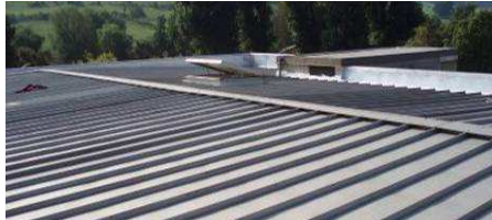
Clarabóia protegida em telhado de Galvalume®
