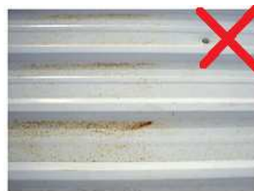
Limalha de aço depositada sobre a cobertura que se oxidou
