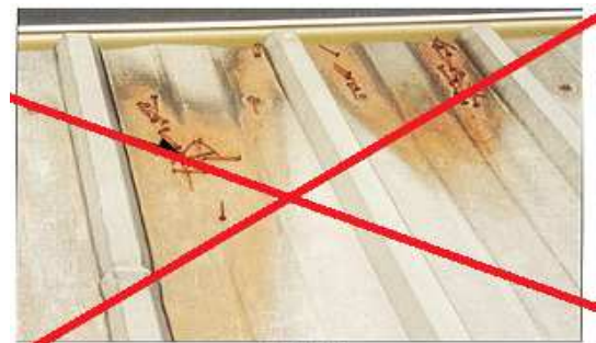
Pregos ou parafusos deixados para trás causam oxidação do Galvalume®
