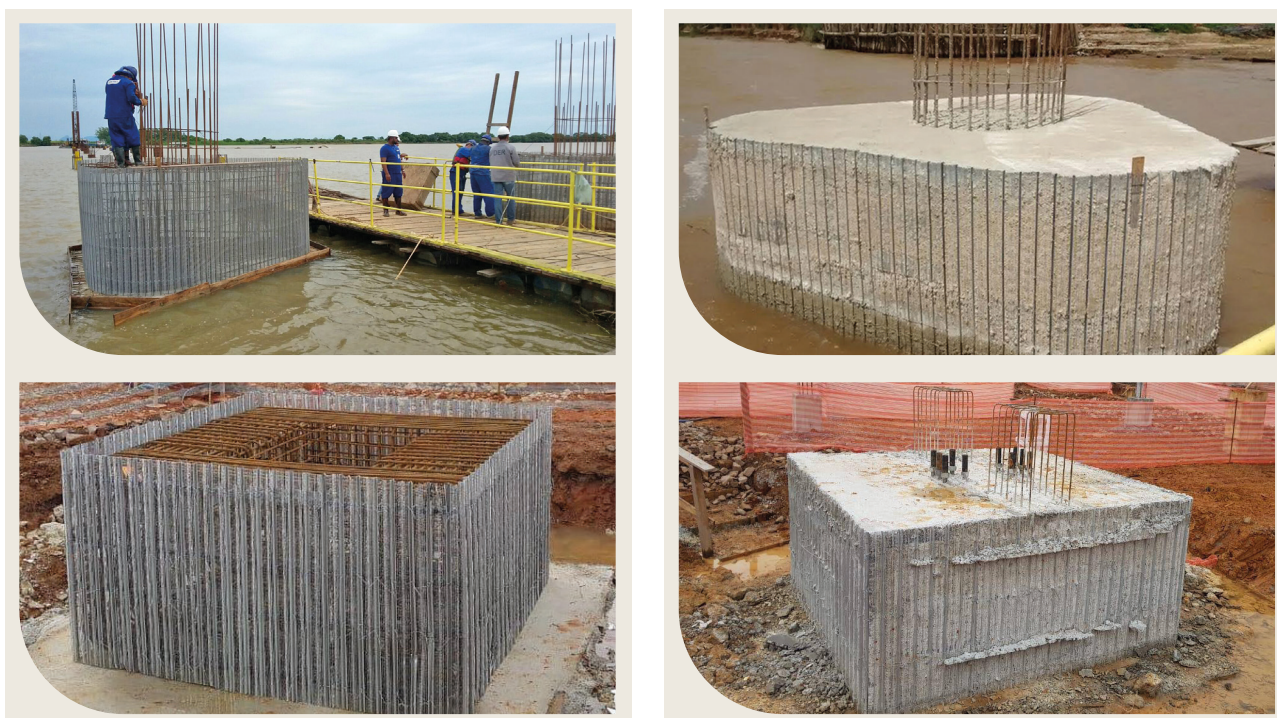
Figura 7 - À esquerda, blocos com APS e Fôrma Incorporada antes da concretagem; à direita, os mesmos blocos já concretados
