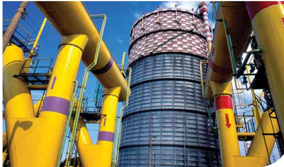
Gasômetro em Tubarão: reaproveitamento de gases garante autossuficiência energética
