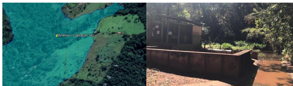
Figura 3: Captação de água Minerita: 160 m³/dia.
