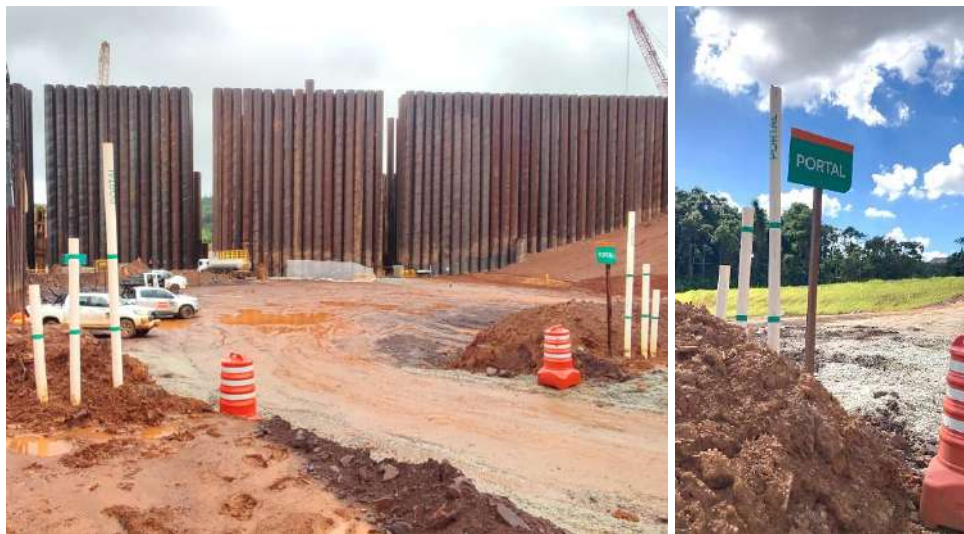
Portal indicativo na rota de fuga para caminhões
