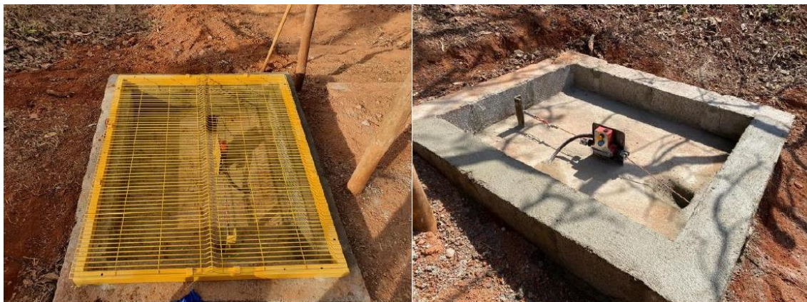
Imagem 7.1 – Caixa de ancoragem da chave de corda nas ombreiras da Barragem Serra Azul.
