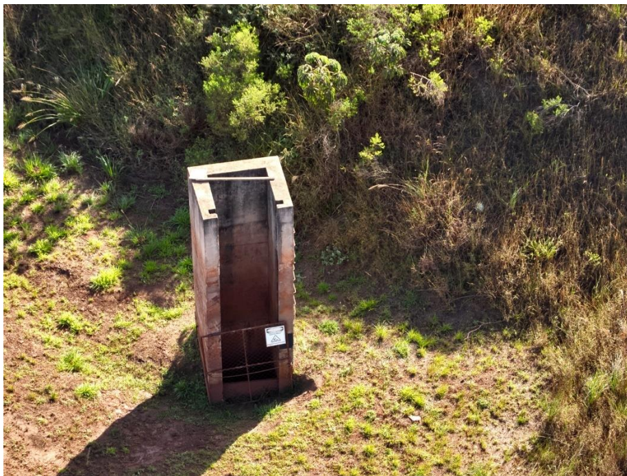
Figura 24: Reservatório contém a (tulipa de drenagem).
