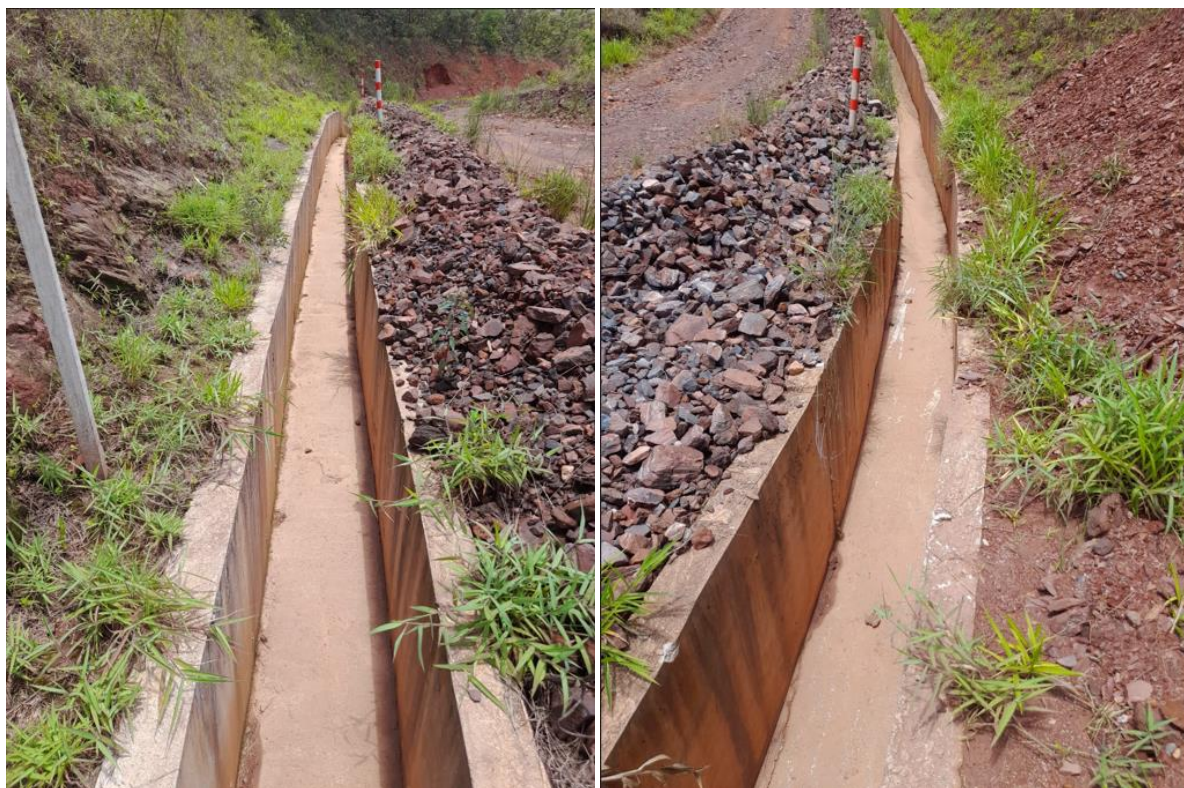
Imagem 1 a 3: Canal de desvio.
