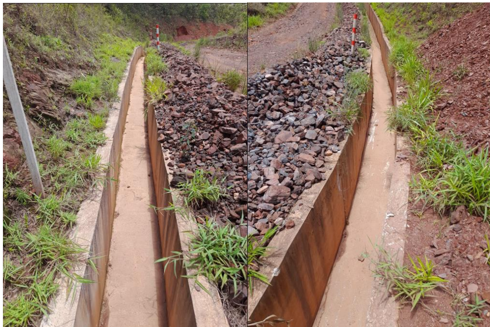
Imagem 1 a 3: Canal de desvio.
