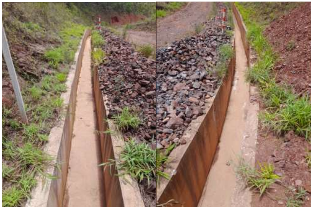
Imagem 1 a 3: Canal de desvio.
