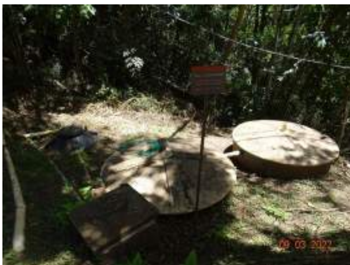
Figura 76 – Sistema Fossa Filtro Sumidouro da portaria principal
