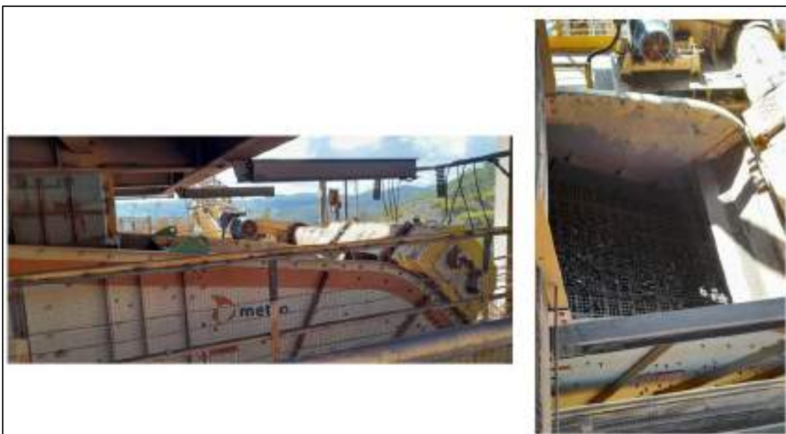
Figura 21 - Sistema de Peneiramento Secundário
