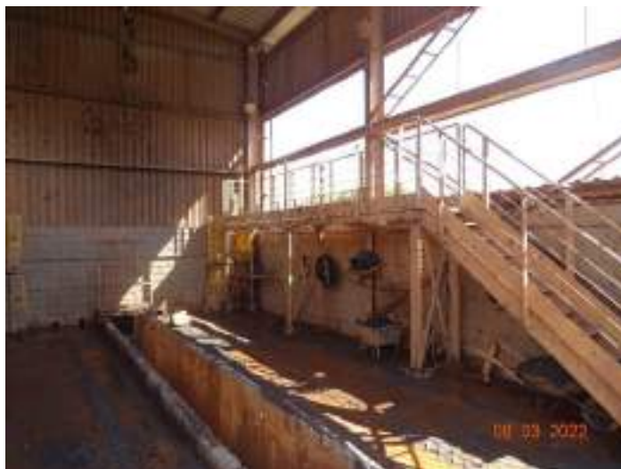
Figura 59 - Passarelas metálicas para proteção do operador
