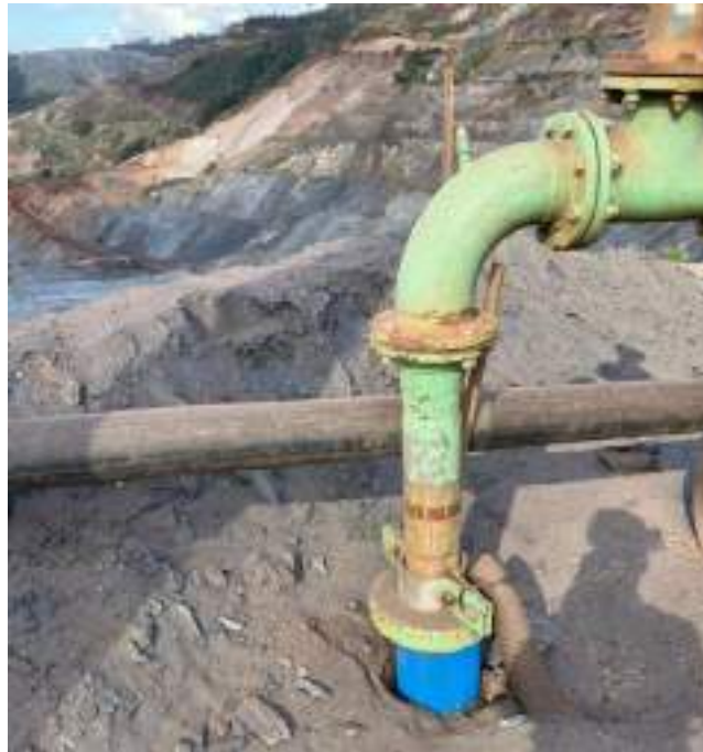
Figura 87 - Poço Tubular 04 - Portaria 1108047/2022
