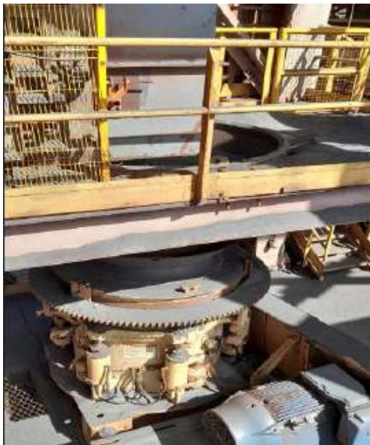
Figura 22 - Sistema de Britagem Terciária
