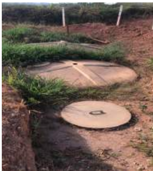
Figura 82 - Sistema Fossa Filtro Sumidouro do Galpão Testemunho
