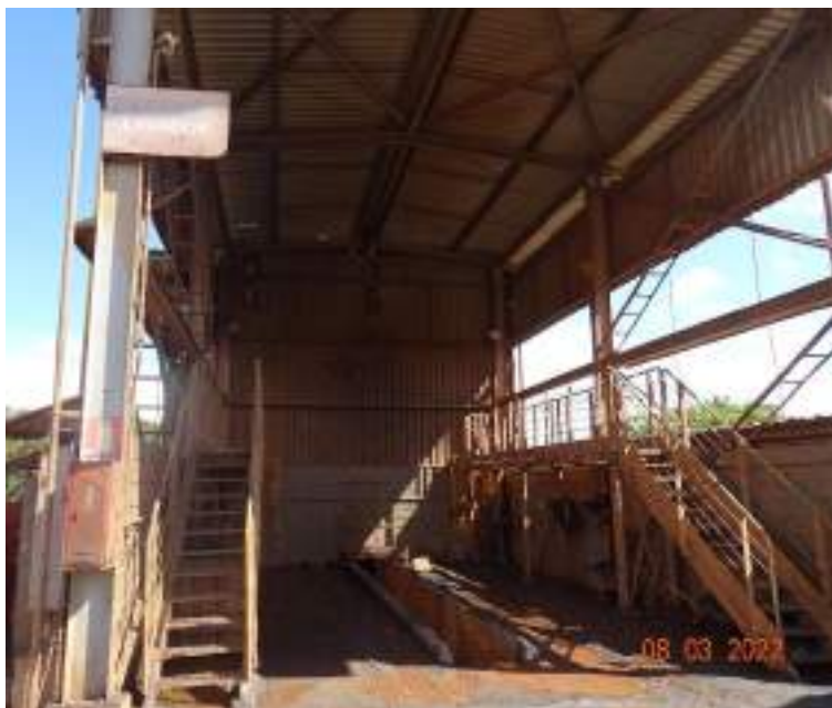
Figura 58 - Lavador de veículos/equipamentos
