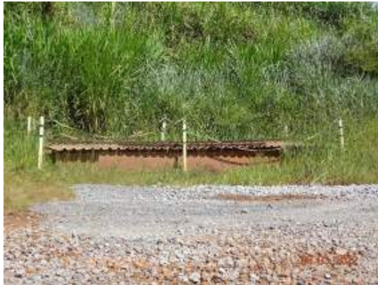
Figura 68 - Caixa Separadora de Água e Óleo
