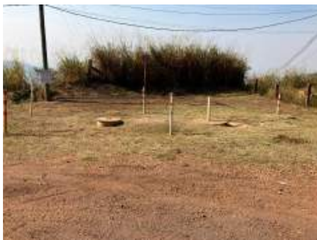
Figura 80 - Sistema Fossa Filtro Sumidouro da CETAR
